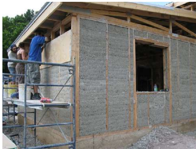
Zdjęcie 9. Najprostsza metoda zastosowania betonu konopnego czyli ręczne układanie mieszanki w szalunku.
