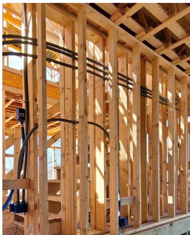
Zdjęcie 3. Instalacja elektryczna poprowadzona wewnątrz ściany
