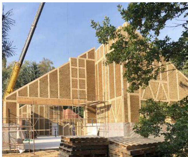
Zdjęcie 4. Budowa „ASZ House” w Łodzi z prefabrykatów drewniano-słomianych (2018–2019). Proj. Koziej Architekci
