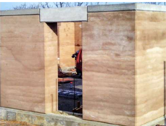
Zdjęcie 3. Wmontowane żelbetowe nadproża w ściany z ziemi ubijanej, jako przykład złych efektów wizualnych
